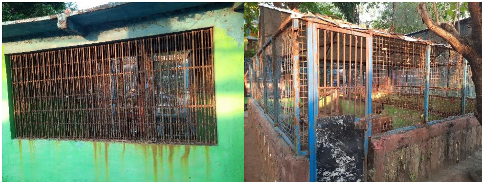
Gambar 3 Kandang yang mengalami korosi (Sumber: Dokumentasi peneliti)
